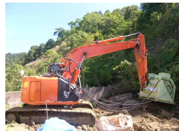
親機稼働状況
